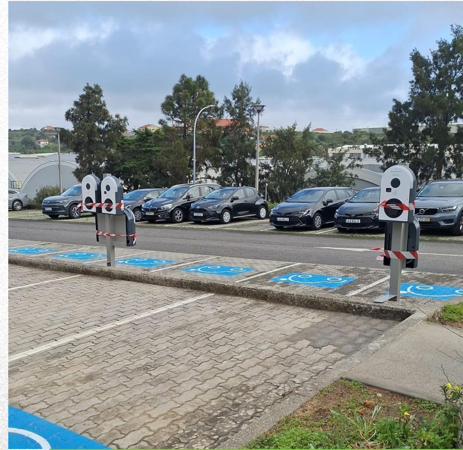
104 postos de carregamento Potência - 600kW
